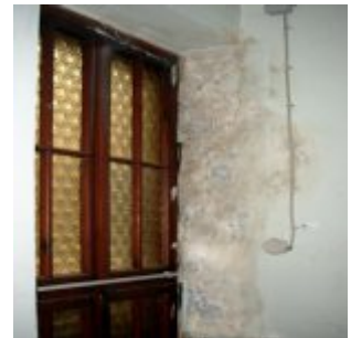
Bild rechts 4 Tage nach der Behandlung mit Porozid -Antischimmel-Spray, keine weitere Ausbreitung des Schimmelfarbens. Die Schimmelflächen haben ihre Farbe geändert und sind blasser geworden. Ein Zeichen dafür, dass die Schimmelpilze abgestorben sind. Die Tapete kann entfernt werden.
