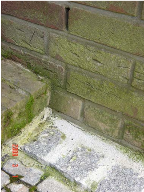
Sichtmauerwerk mit Vergrünung
